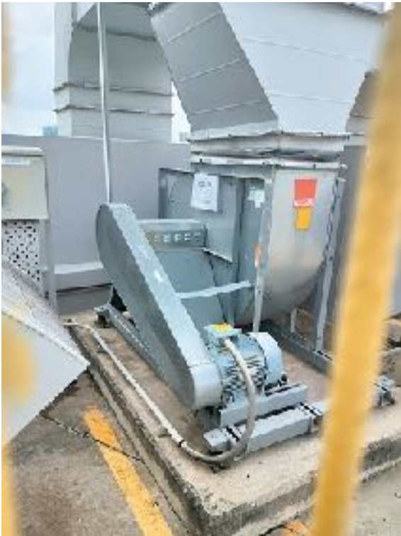
厨房の吸排設備例（屋上）
